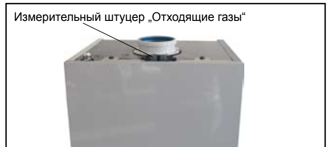
Рис.: Измерение отходящих газов на закрытом котле
