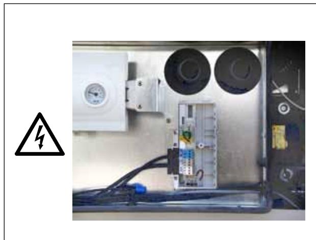
Рис.: Клеммная коробка: Опасность поражения электрическим током
