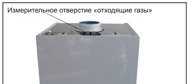
Рис.: Измерение отходящих газов на закрытом котле
